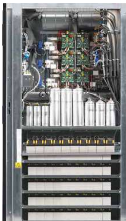
EQUIPAGGIAMENTO BATTERIE INTERNE
